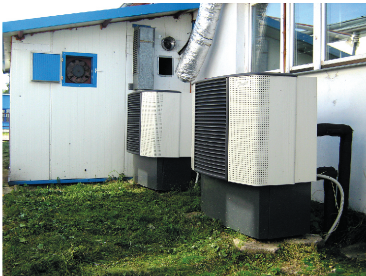
Fot. 1. Moduły zewnętrzne powietrznych pomp ciepła DHP-A wraz z kanałem doprowadzającym ciepło odpadowe.
